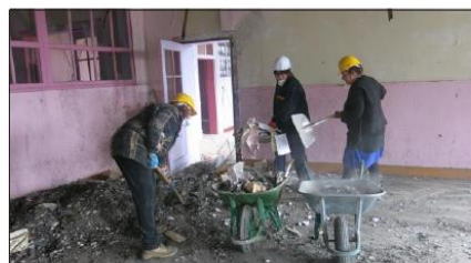
Les parents ont évacué les gravats de l'incendie du Nouvel An 2015. Photo L'Alsace
