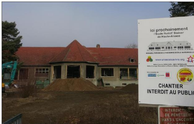
L'aile droite accueillera l'école élémentaire, l'aile gauche le jardin d'enfants. L'espace central, ou forum, abritera la restauration scolaire, mais peut aussi se transformer en salle d'activités, de réunion ou de conférences. Photo L'Alsace
